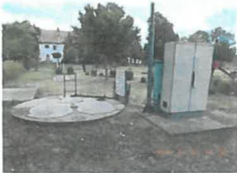
Bartók B. úti átemelő telep
