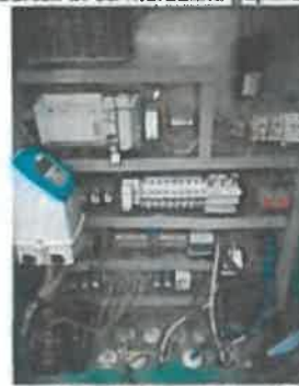
Bartók B. úti átemelő vezérlés
