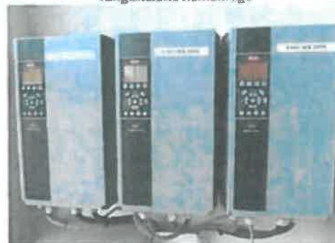
Recirkulációs szivattyúk frekvenciaváltói
