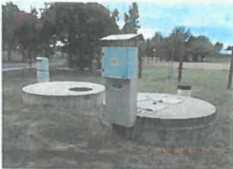
Téglás u. átemelő telep
