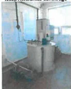
Polyelektrolit oldó és adagoló berendezés
